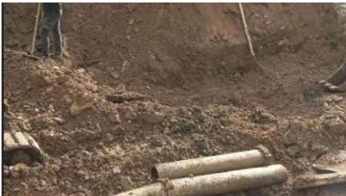
Tuberías de agua rotas tras hundirse una calle en Anglès (Girona)
