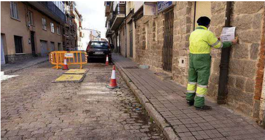
Zona en la que se tuvo que actuar por el hundimiento de la calle. / ISABEL GARCÍA
